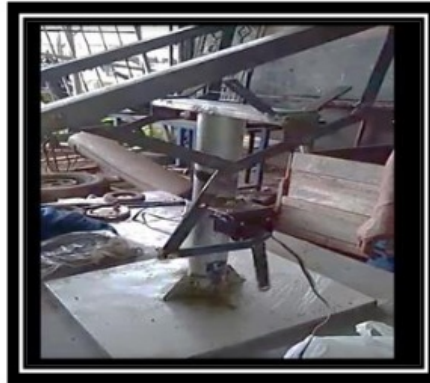
Gambar 4.6 Tiang Penyangga Panel Surya
